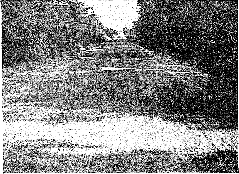
Fig. 20. — Carolina del Sud. — Estabilización de suelo con cemento portland, 15 a 2M cms. de espesor. — Unos 120 kgs. de cemento por m 3 . de suelo. Mezclado en seco, se agrega agua 10 a 12 ½ m. de mezcla y se compacta con rodillo de 5 toneladas.
